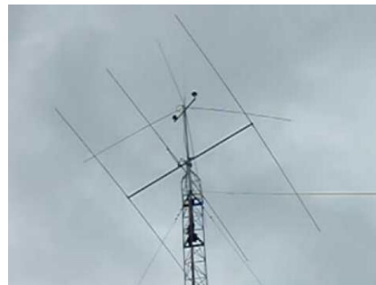
Torre com antenas tipo Yagi e plano terra
