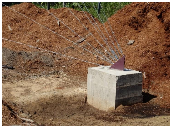
Bloco de ancoragem de 8 estais.
